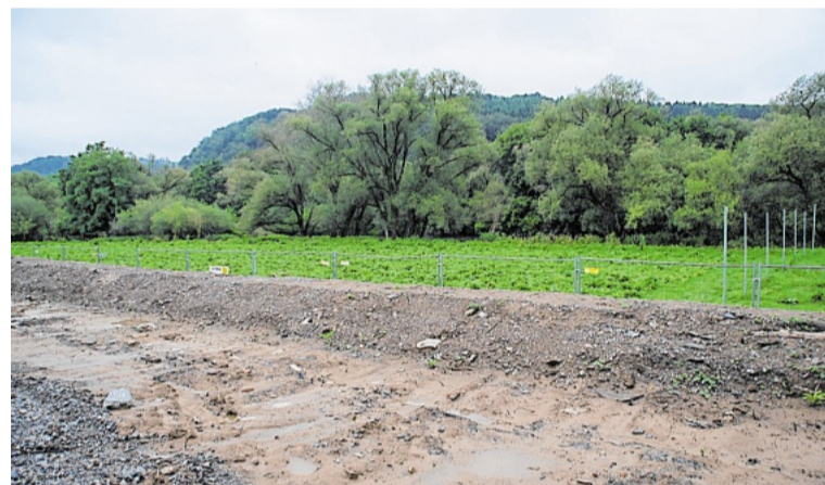
Zur Lenne musste das Grundstück durch einen Deich abgeschottet werden, damit der Fluss bei Hochwasser nicht das Firmengelände flutet.
